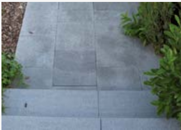
Feuchte im Unterbau
