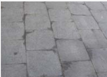
Feuchte im Unterbau
