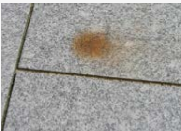
Eisenoxydanteil im Verlegesplitt
